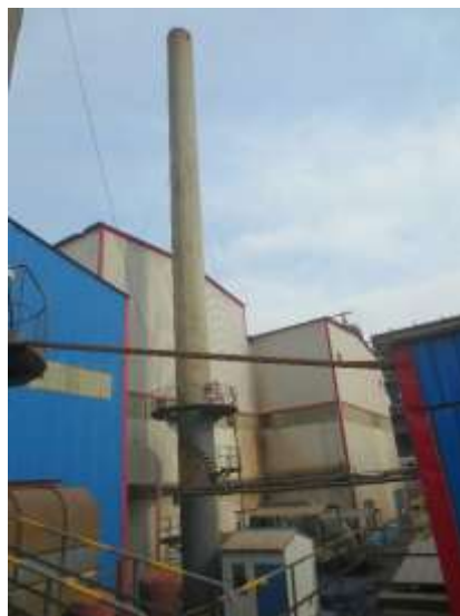
1#35t/h 燃气锅炉排气筒
