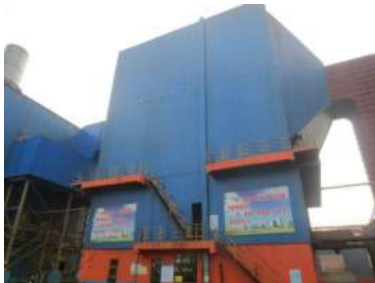
烧结机头废气三电场静电除尘器
