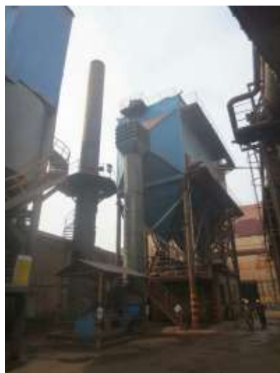
配料室布袋除尘器+排气筒
