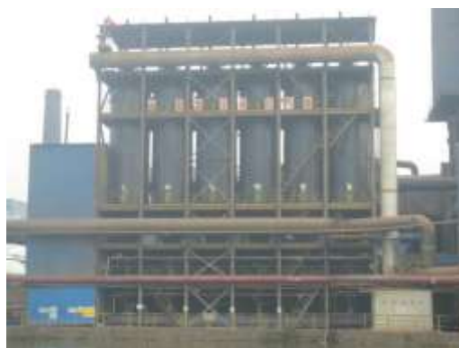
荒煤气净化袋式除尘器
