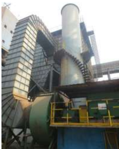
2#高炉矿槽上料废气布袋除尘器+排气筒
