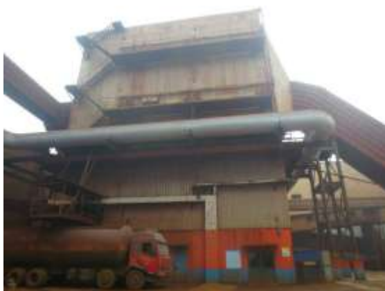
烧结机机尾废气三电场静电除尘器
