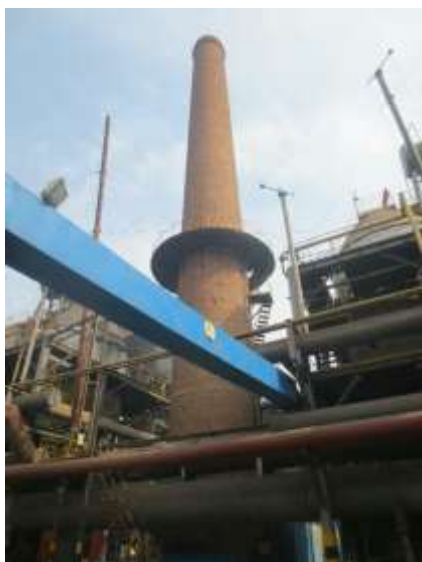
热风炉烟气排气筒
