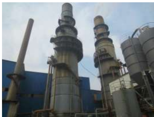
烧结机头废气石灰石-石膏湿法脱硫系统
